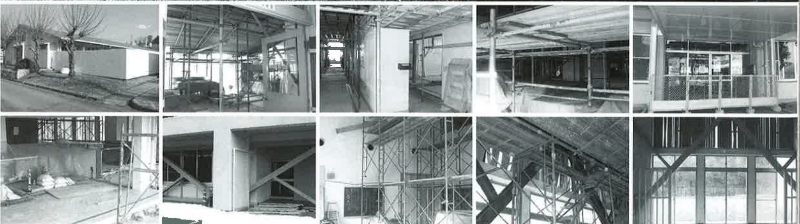
— だいち作業棟・おおぞらB棟の耐震工事が終わりました。 —
